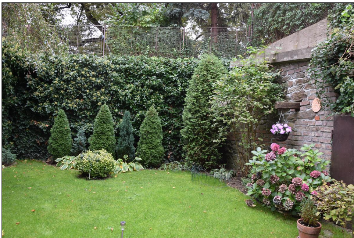
Obr. 22: Domažlice, okr. DO – pohled na zeď sj.11 od severu, tedy z prostoru parcely 510/2. Zdivo je z této strany nejen neprostupně porostlé břečťanem, ale ještě pokryto souvislou cementovou omítkou (foto T. Mařík)
